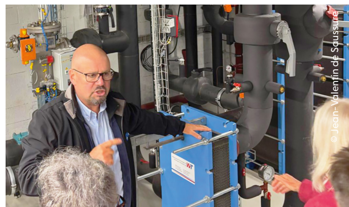
Didier Orlandi, responsable de l'exploitation des eaux usées, présente l'échangeur thermique du chauffage à distance des Rojalets.
