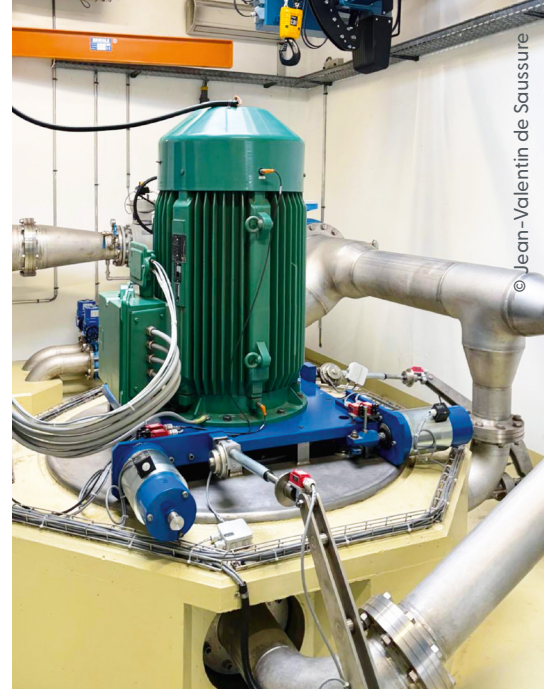
La turbine de la station de turbinage et pompage de Coppet.
